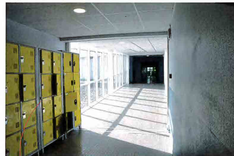
Vue 1 : couloir non PMR
