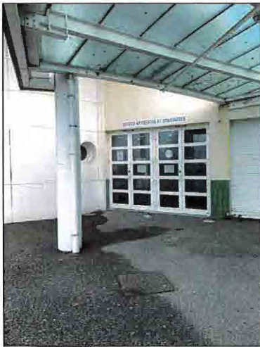
Point 3 signalétique entree générale
